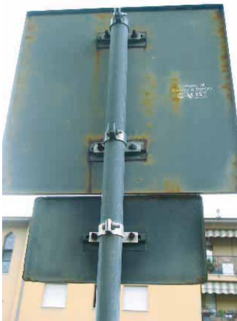
Il retro della segnaletica non lascia adito a dubbi: è in violazione di legge.
